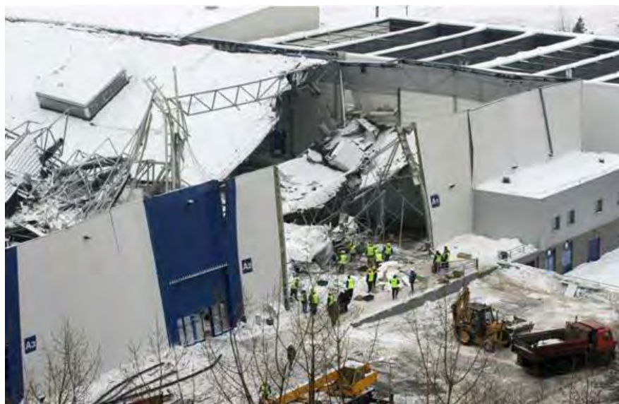
Рисунок 4.1 - Обрушение кровли торгового зала на Международной ярмарке в Катовице, Польша, 2006 год
